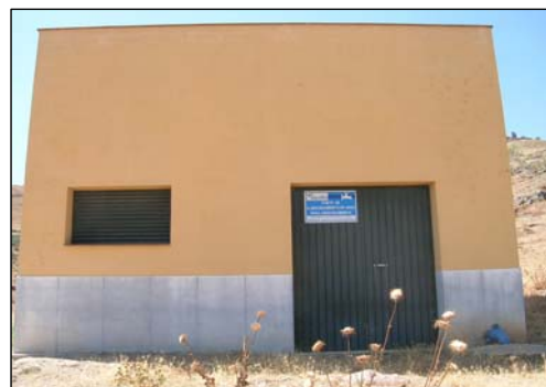
ESTACIÓN DE BOMBEO DEL PANTANO.
